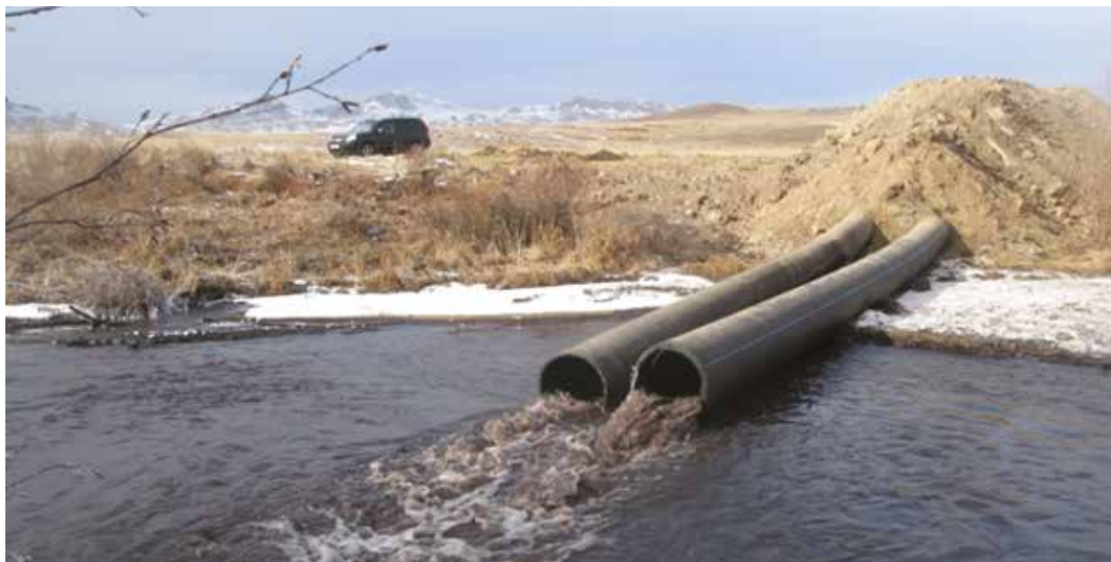
Рис. 2. Трубы сброса промышленных вод с основной технологической площадки в р. Межегей
