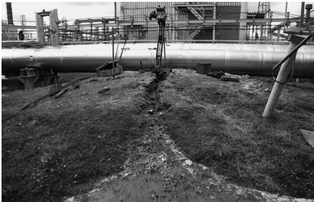
Рис. 2. Бугор пучения на площадке АВО газа ДКС УКПГ-1В, вскрытый разгрузочной скважиной (июнь 2009 г.)
